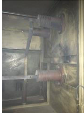
Slika 1. Izgled unutrašnjosti odvodno – dovodne ćelije 35 kV „Pravac ka TS 110/35 kV/kV Niš 3C“ posle havarije
