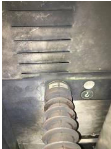
Slika 3. Izgled potpornog izolatora u odvodno – dovodnoj ćeliji 35 kV „Pravac ka TS 110/35 kV/kV Niš 3C“ posle havarije
