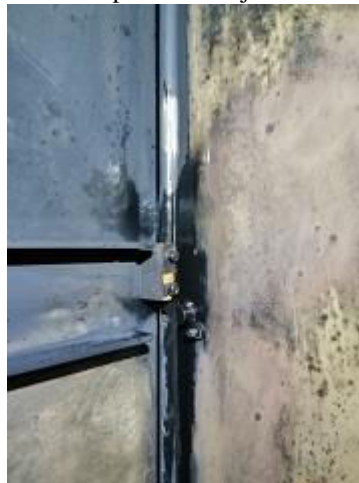
Slika 4. Klizna šipka pokretne pregrade u odvodno – dovodnoj ćeliji 35 kV „Pravac ka TS 110/35 kV/kV Niš 3C“ posle havarije
