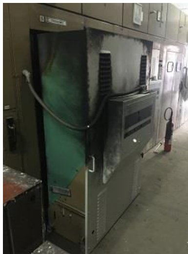
Slika 2. Izgled kolica odvodno – dovodne ćelije 35 kV „Pravac ka TS 110/35 kV/kV Niš 3C“ posle havarije
